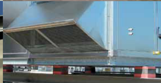
Klimagerätelagerung auf Bürogebäude
